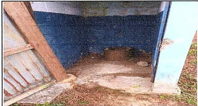
Foto 2: Cambio de losa, porque estan en mal estado.
